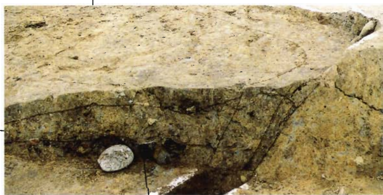
▼ つちかべ 土壁が倒れた建物の断面
